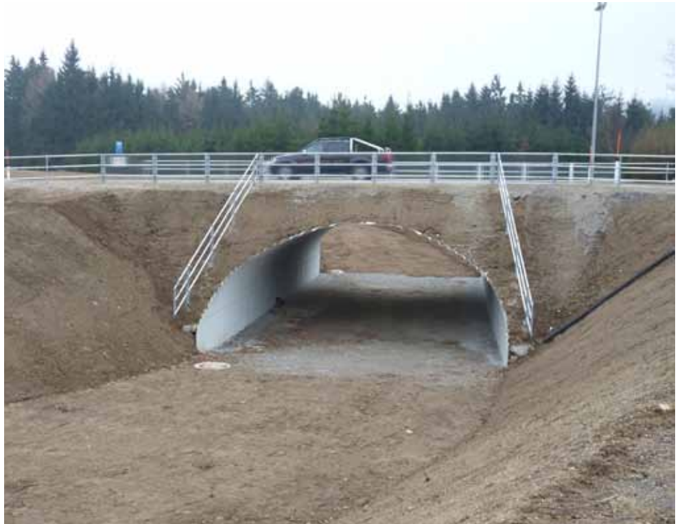
Die Langlaufunterführung in Schöneben trägt zu einer wesentlichen Verbesserung der Verkehrssituation bei
