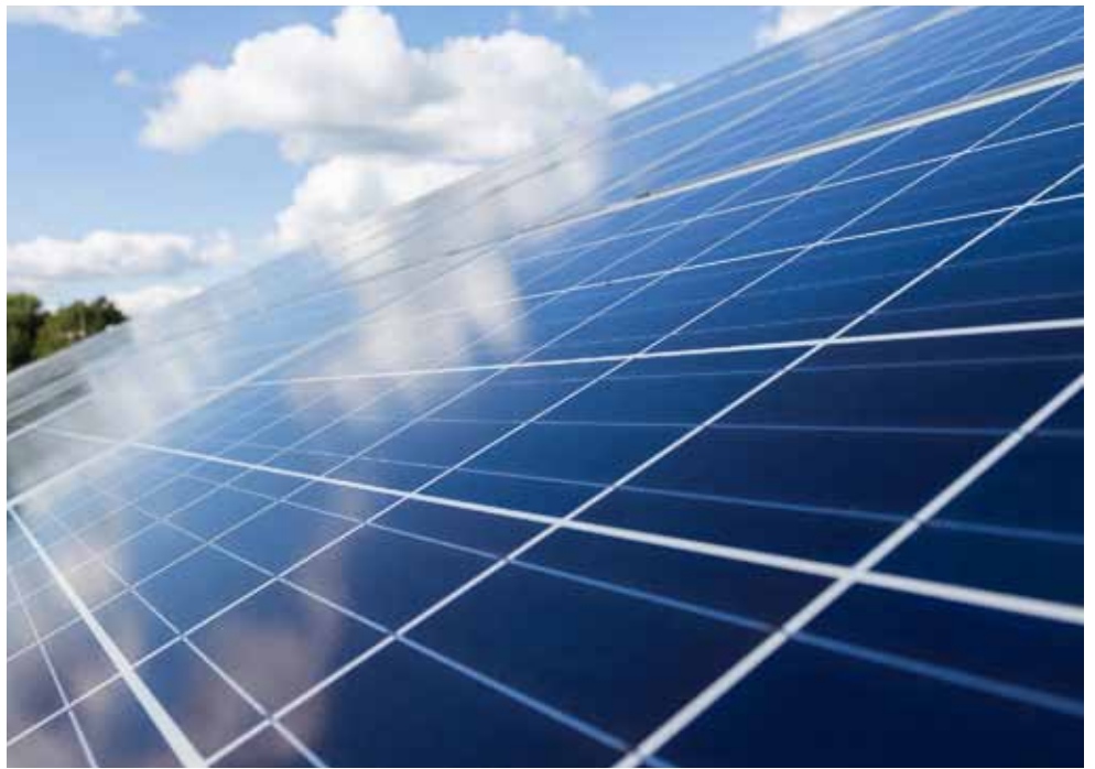
Die Kraft der Sonne nutzen - Photovoltaikanlagen (PVA)
