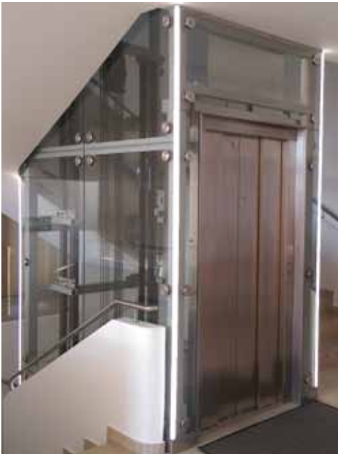
Dank des neuen Aufzuges ist das Rathaus nun barrierefrei
